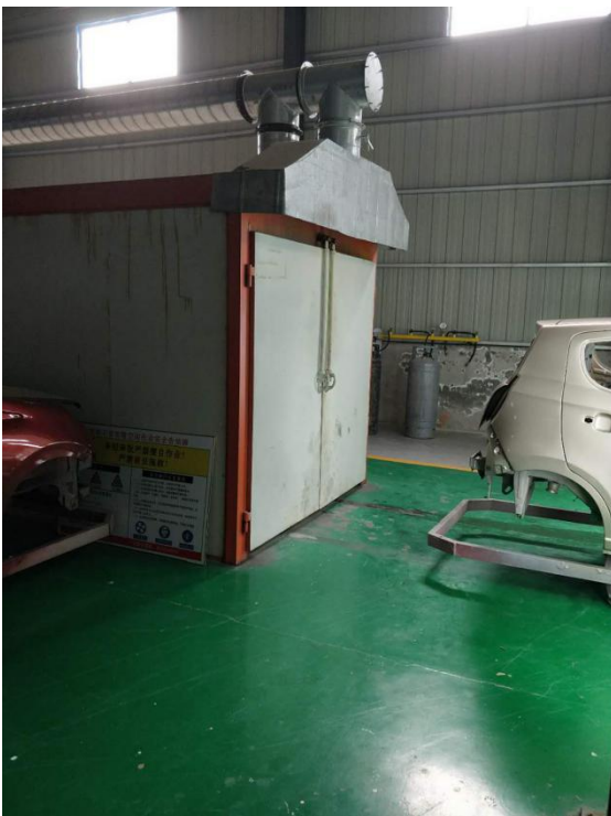
图为整改后罩光清漆烘干室废气收集罩
