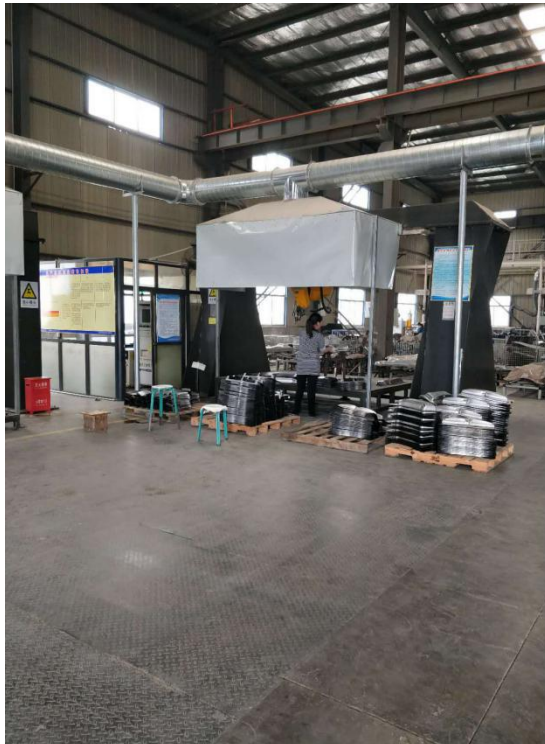
图为整改后 3 号激光切割废气收集罩
