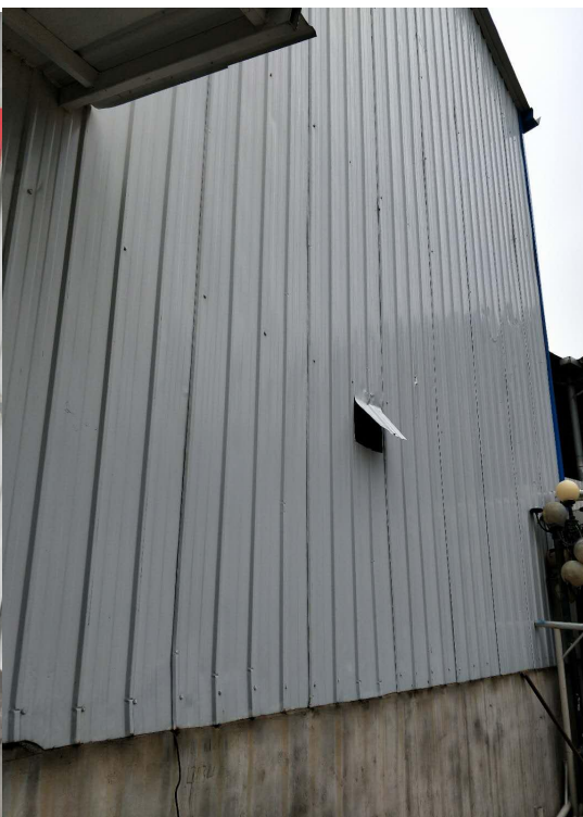
图为危废间排风口
