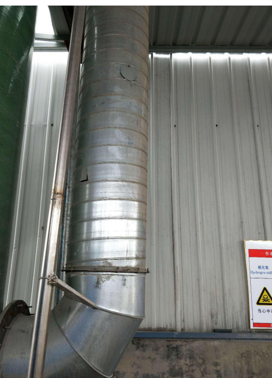
图为整改后 P2 设备处理前
