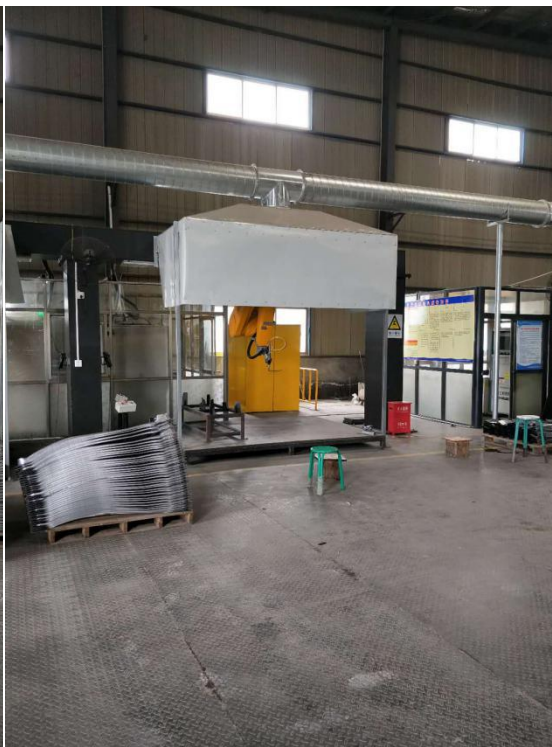
图为整改后 2 号激光切割废气收集罩
