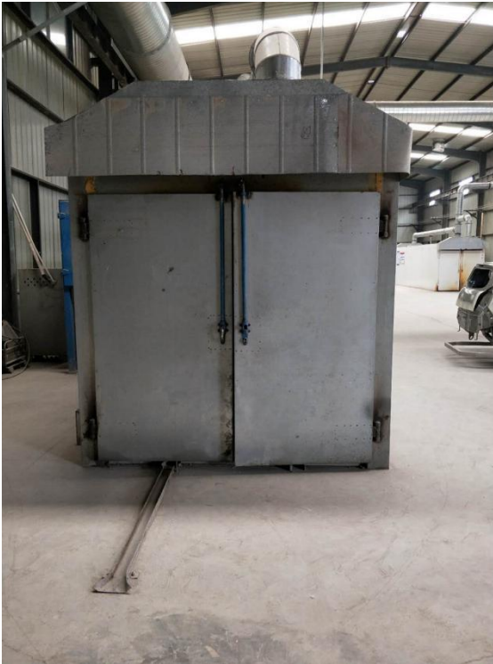
图为整改后腻子烘干室废气收集罩
