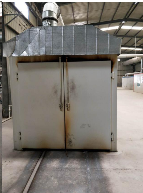
图为整改后电泳烘干室废气收集罩
