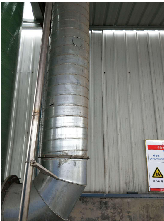
图为整改后烘干室废气处理前检测孔上移
