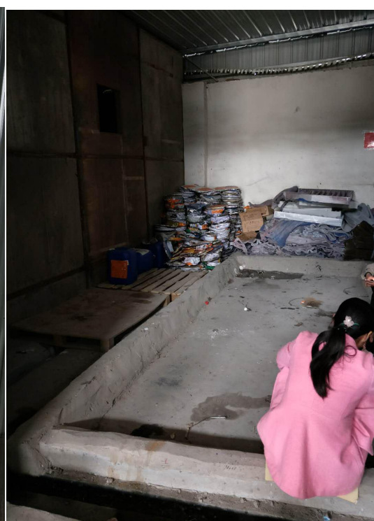
图为 1 号危废间围堰
