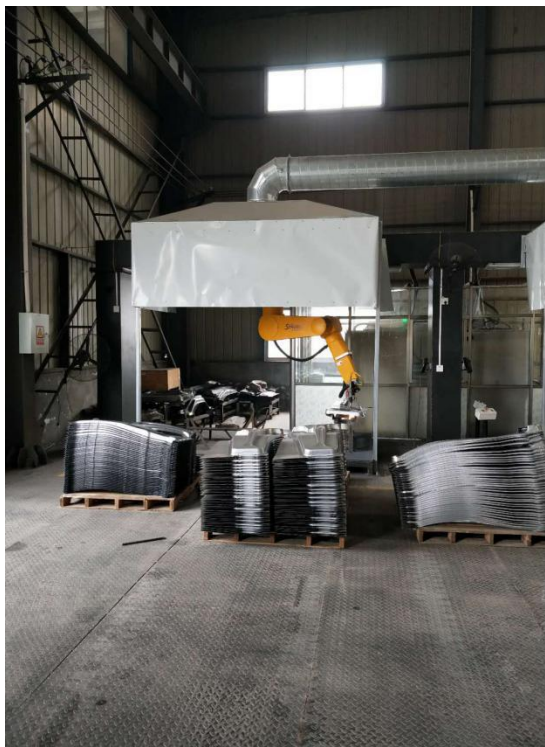
图为整改后 1 号激光切割废气收集罩
